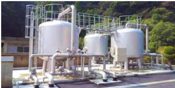
熊本県天草郡苓北町志岐浄水場
